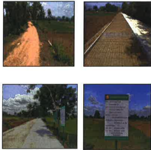
โครงการก่อสร้างถนน ค.ส.ล.บ้านหนองแจ้งน้อย หมู่ที่ ๕ บริเวณ บ้านร้อยศรีเจ็ด ไปสวนนายประจวบ ช่างเหล็ก (ข้อบัญญัติ)
