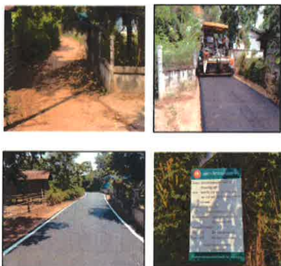
โครงการปรับปรุงผิวจราจรแอสฟัลติกส์คอนกรีต บ้านเสมาใหญ่ หมู่ที่ ๑ บริเวณจาก ศพค. บ้านเสมาใหญ่ ไปบ้านนางอลิษา การถาง (ข้อบัญญัติ)
