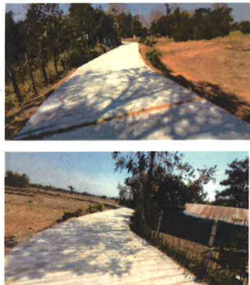
โครงการก่อสร้างถนน ค.ส.ล. บ้านหนองหัวช้าง หมู่ที่ ๗ บริเวณ นายนายสวัสดิ์ โล้นอกถึงบ้านนายพวง ประทุมนอก (ข้อบัญญัติ)
