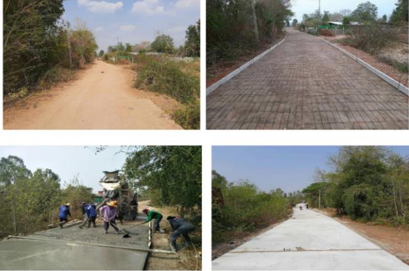
โครงการก่อสร้างถนน คสล.บ้านหนองช้าง หมู่ที่ ๗ บริเวณบ้านนายอุดม บุญนอก ไปประปาหมู่บ้าน (ข้อบัญญัติ)
