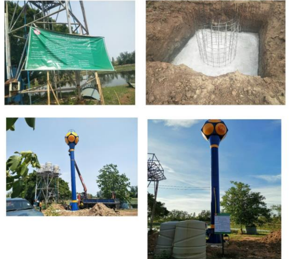
โครงการก่อสร้างระบบประปาหมู่บ้าน บ้านโนนใหญ่ หมู่ที่ ๘ (จ่ายขาดเงินสะสม)
