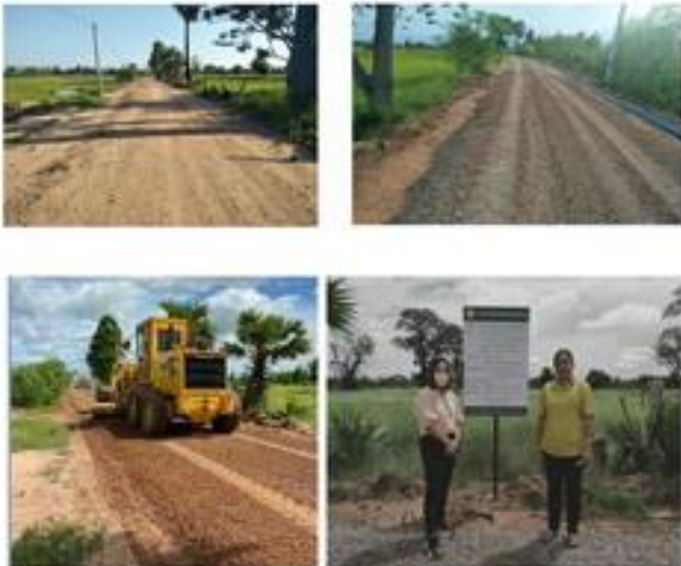
โครงการก่อสร้างถนนหินคลุก บ้านไร่อ้อย หมู่ที่ ๔ บริเวณจากหมู่บ้านไร่อ้อย ไปบ้านโนนตัว (ข้อบัญญัติ)
